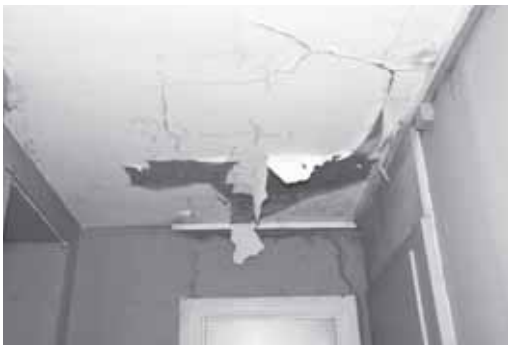
Desolate Zustände in einem der Mietshäuser, die von der Stadt- und Kantonspolizei durchsucht wurden.
